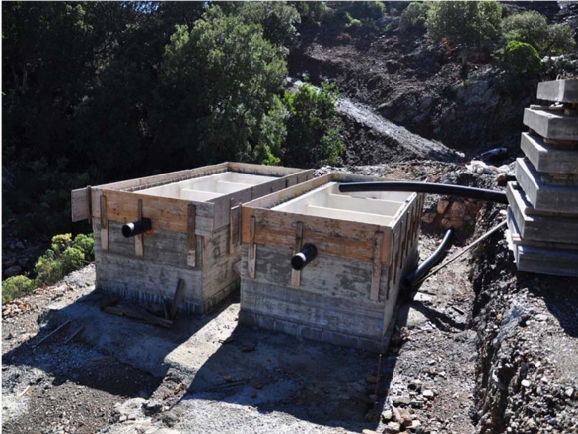
Figura 6.3-2: Acque vasche per trattamento passivo effluenti contaminati
